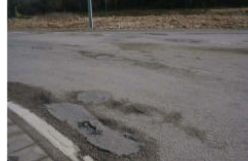
Beständighetsproblem orsakat av inträngande vatten i gränssonen mot rondellen.
