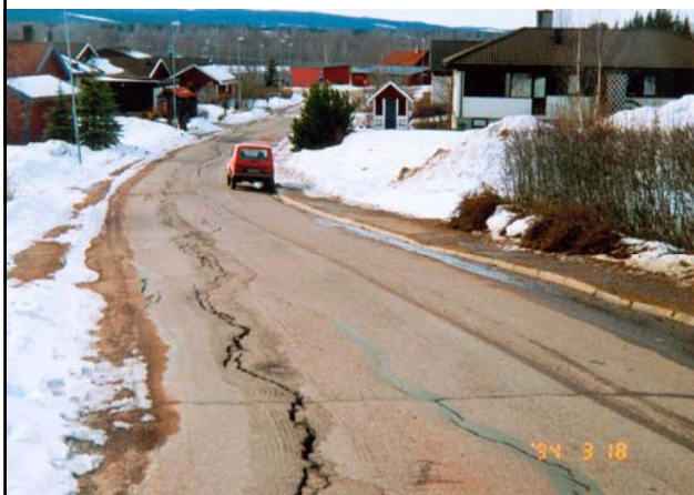
Bostadsgata med tjälsprickor
