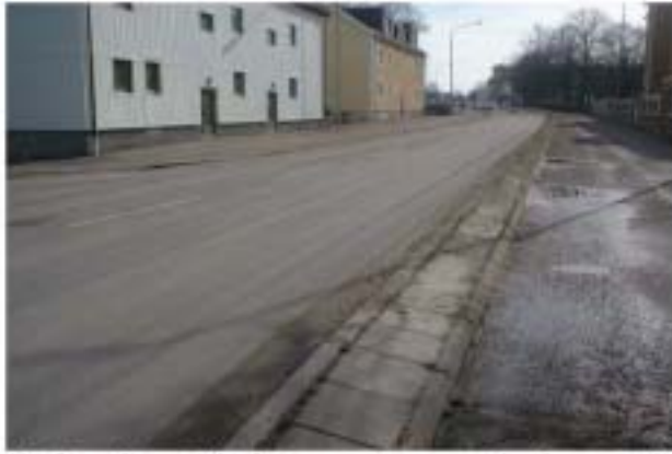
Kraftigt slitage i hjulspåren på en avsmalnad gata, tidigare bred men gjordes smalare för byggande av cykelbana. Nya Tinnerforsvägen, Linköping
