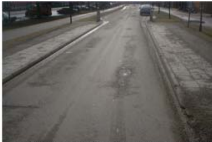
Kraftigt slitage från trafik med dubbade däck. Westmannagatan, Linköping
