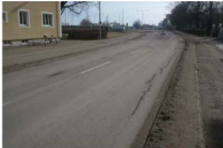
Sprickor orsakade av tung trafik på en smal gata i tätort. Nya Tinnerforsvägen Linköping.
