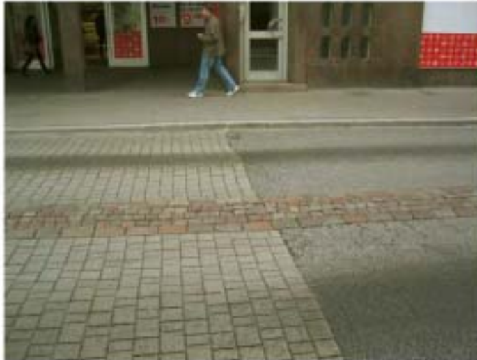
Belastningsbetingade sprickor orsakade av tung spårbunden trafik Södra Förstadsgatan, Malmö
